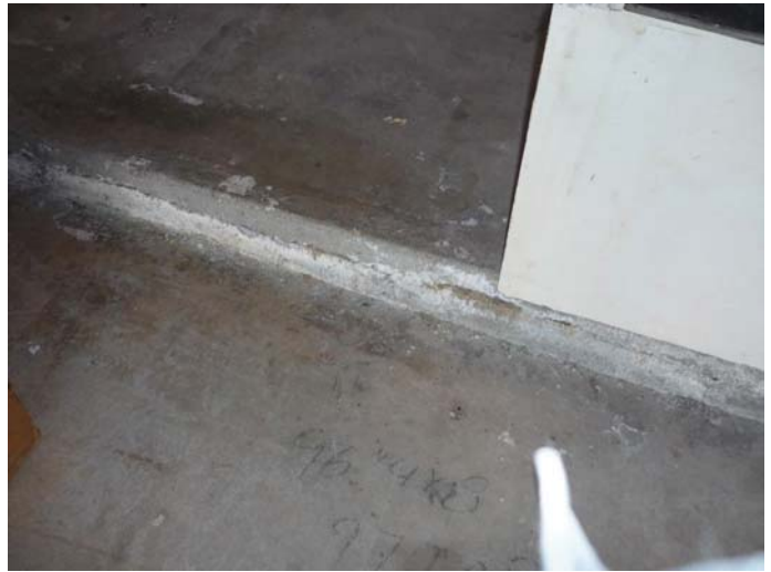
Cold pour crack with efflorescence garage.
