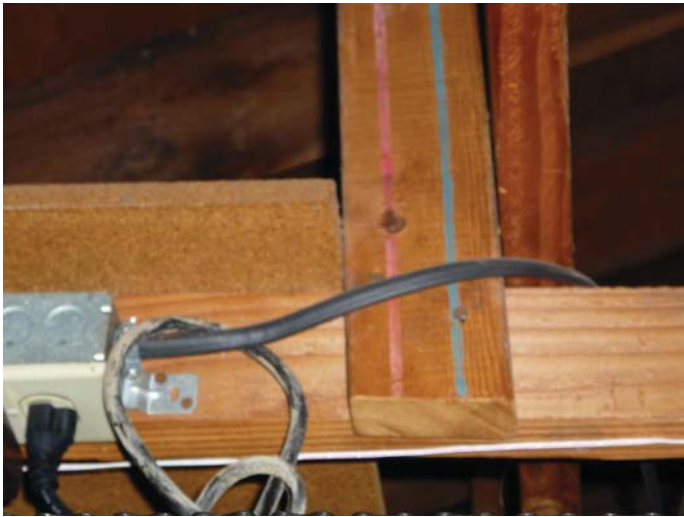
Improper garage conduit.
